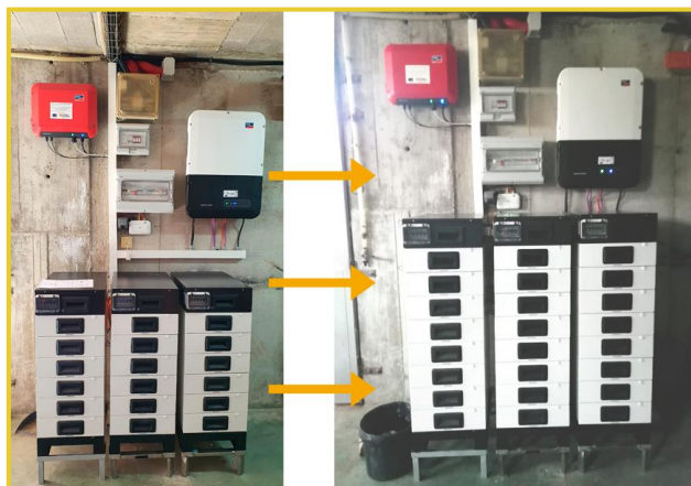
Imagen: Instalación con Sunny Boy Storage y 3 armarios de baterías de litio HV en paralelo
